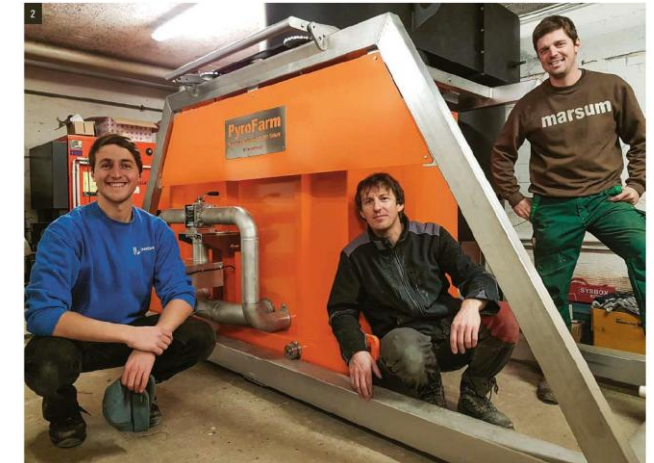
2. Die 40 kW-Pyrolyseanlage PyroFarm von Kaskad-E GmbH nach fertiger Installation am 1. Dezember 2020. Das Aufbauteam ist zufrieden: von links Fridolin Hanel und Stephan Gutzwiler (Kaskad-E), Michael Kipfer (Betreiber, Landwirt Biohofacker in Stettlen).
