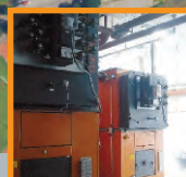
Le caldaie a cippato
