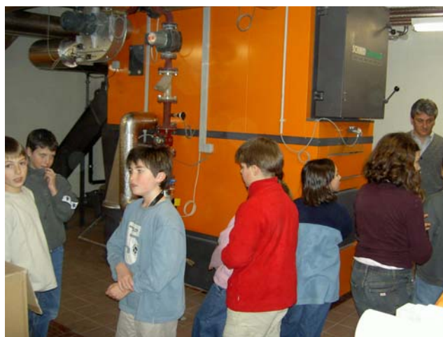
La nuova caldaia, che riscalda gli allievi grazie alla legna.
